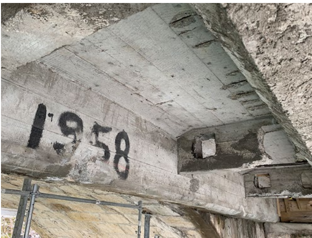
Schadhafter Beton vor Verstärkung
